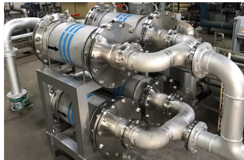
食品製造工場（2016年11月設置） LSFTC-125タイプ×4基
