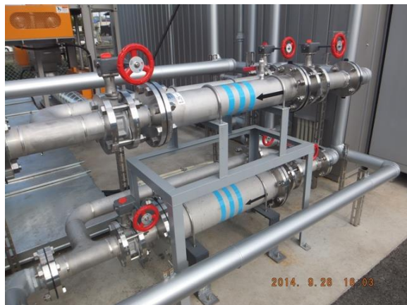
紙製品製造工場（2014年9月設置） LSFTC-65タイプ×1基、50タイプ×1基
